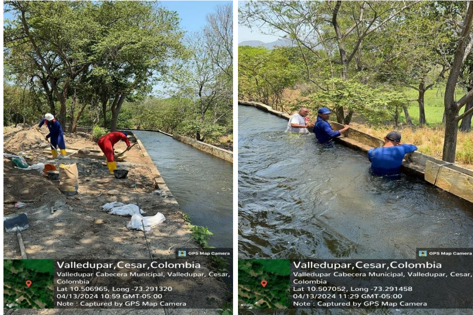
Evidencia elevación de las paredes del canal elevado
