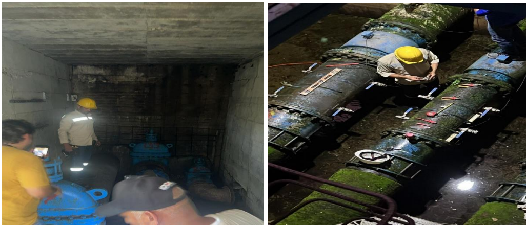
Evidencia de recuperación equipos para el funcionamiento de la planta de tratamiento de agua potable
