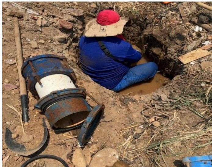
Evidencia Optimización sistema de Acueducto Ciudadela Comfacesar.
