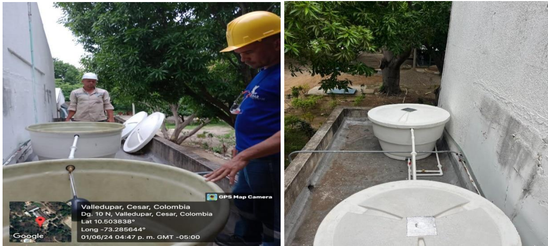
Evidencia instalación tanques de almacenamiento de agua potable en el laboratorio PTAP
