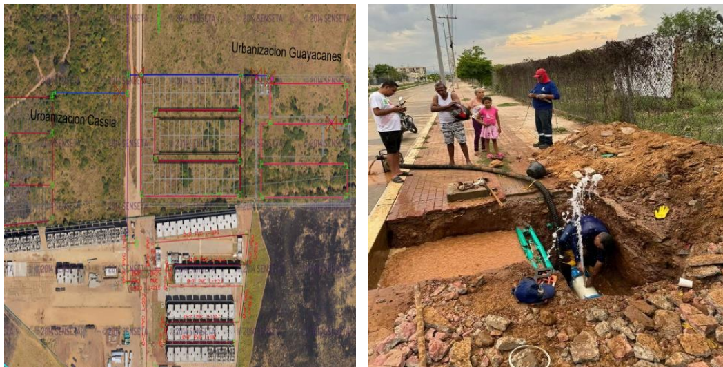
Ubicación y evidencia de actividades ejecutadas en el sector de las Urbanizaciones Cassia y Guayacanes
