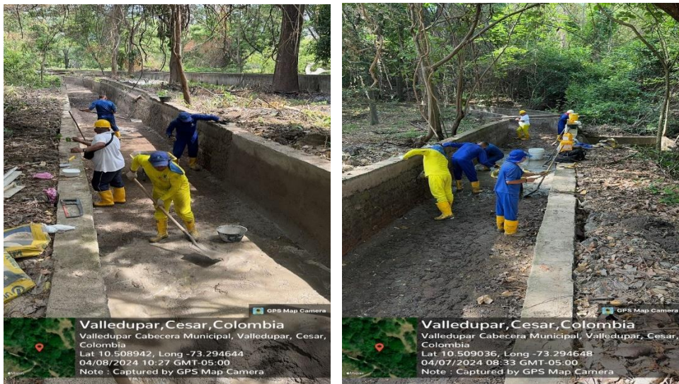
Evidencia Mantenimiento en general y reparación de fisuras y grietas del canal Solución
