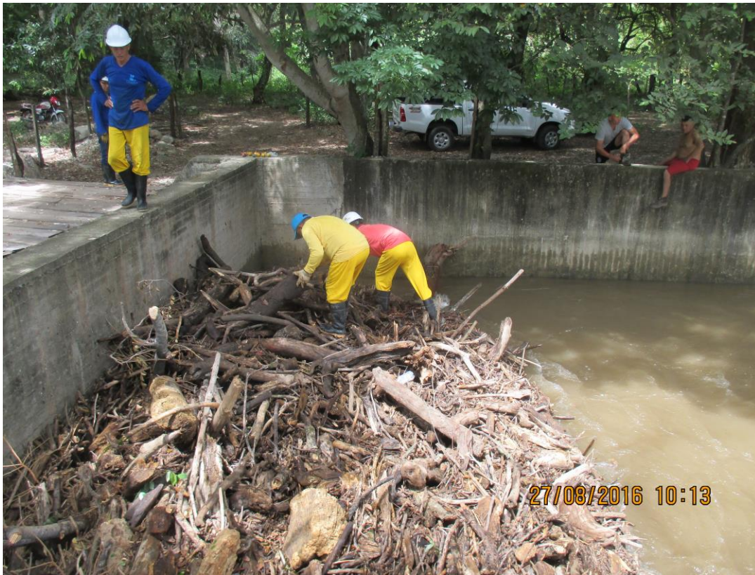
Imagen 19: Acumulación de material vegetal en la bocatoma.
