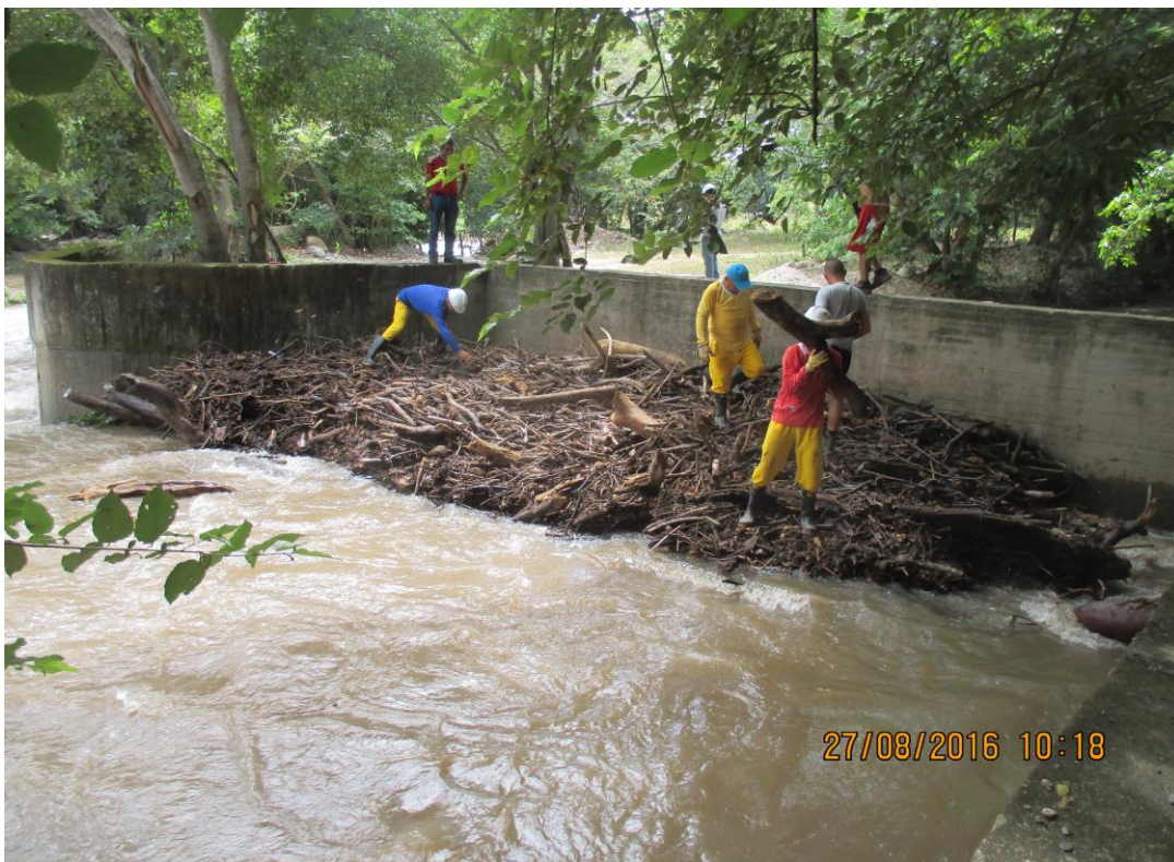
Imagen 20: Acumulación de material vegetal en la bocatoma.
