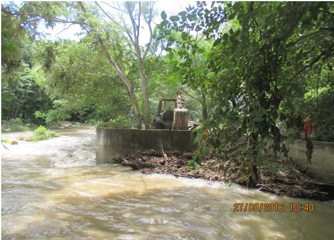
Imagen 21: Acumulación de material vegetal en la bocatoma.
