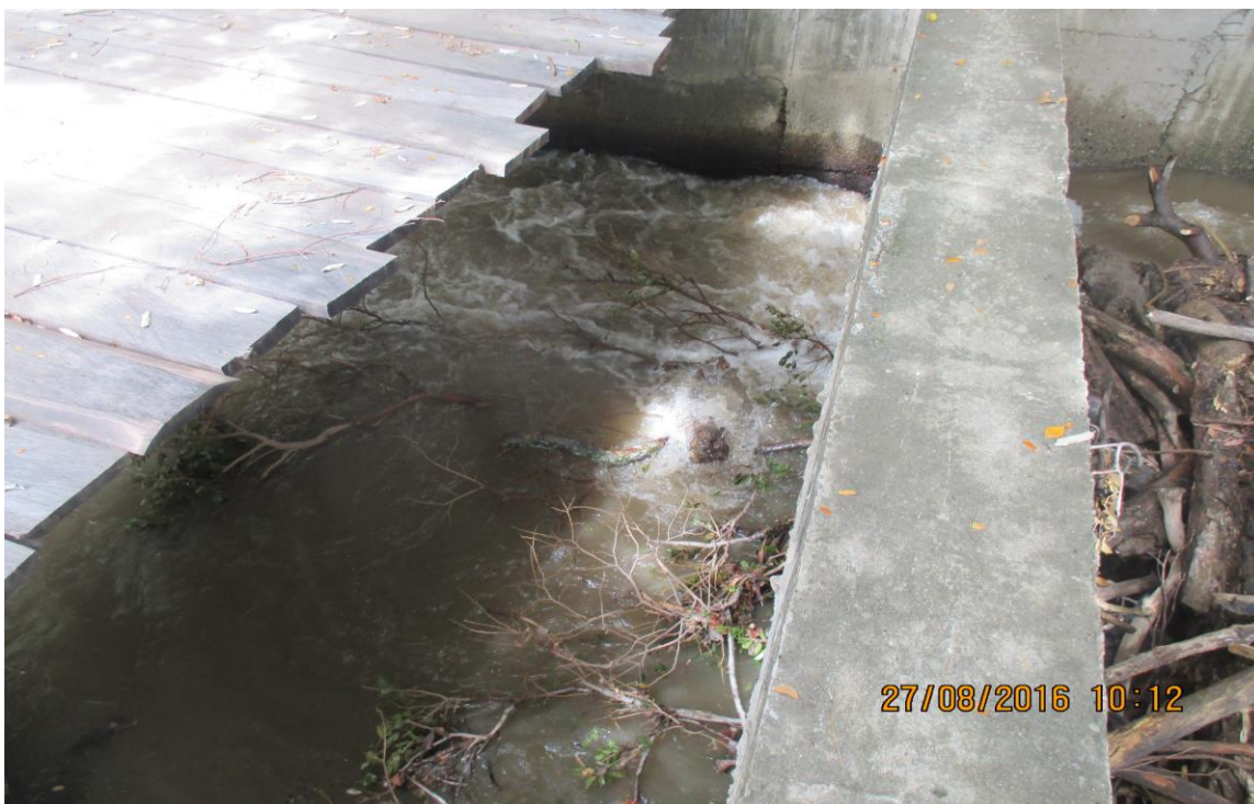
Imagen 22: Acumulación de material vegetal en la bocatoma.
